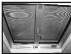
Issue de secours à l'événement de plafond
