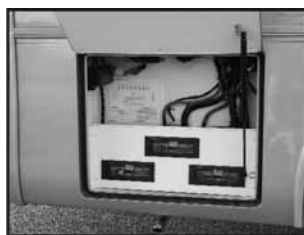
Panneau de fusibles dans le compartiment électrique extérieur d'unité à moteur diesel à l'arrière.
