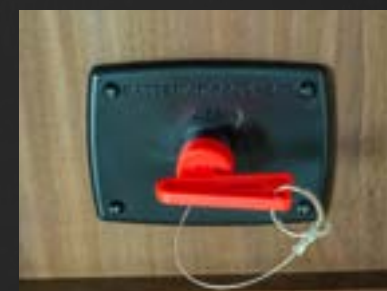
Disjoncteur de batterie
